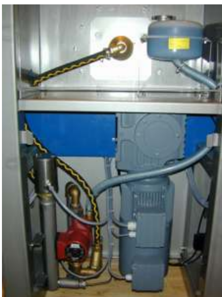
Heizkreislauf und Antrieb dose VGI
