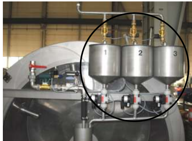
Behälter für automatische Dosierung
